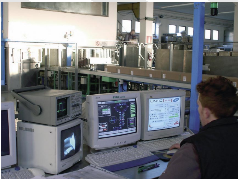
L'impianto di sterilizzazione a raggi beta in Bioster. In primavera 2008 sarà aperto una nuova sezione dedicata al trattamento a irraggiamento nello stabilimento di Poggio Rusco.
